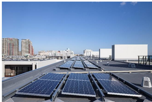
▲ザ・パークハウス 新浦安マリソレイユ 屋上太陽光パネル
